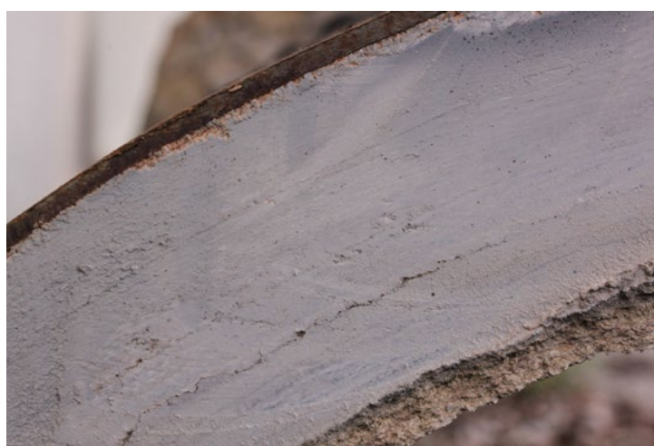
Dépôts de tuf dans une conduite forcée de turbine hydroélectrique (environ 5 cm d'épaisseur). Cl. © P. Collin
